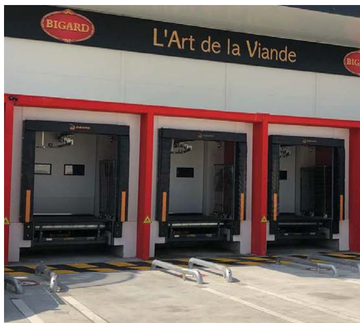
Les sas de quai frigorifiques sont installés directement sur la façade.
