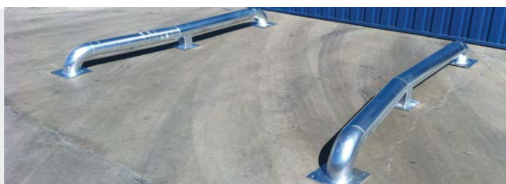
Les guides facilitent l'entrée des véhicules dans les quais de chargement et les protègent des éventuels coups.
