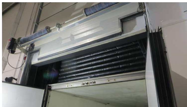
Grâce à l'ABHM, un niveau d'isolation élevé est atteint à l'intérieur des installations.
