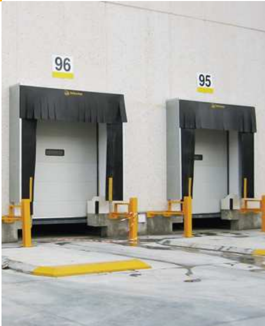
Abrigos de muelle fijos instalados directamente en la instalación.
