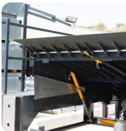
Détail d'une RH12 installée.
